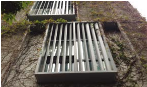
外墙垂直绿化技术、手动外遮阳设施
