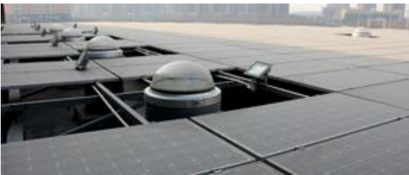
顶部光导照明和太阳能光伏板
