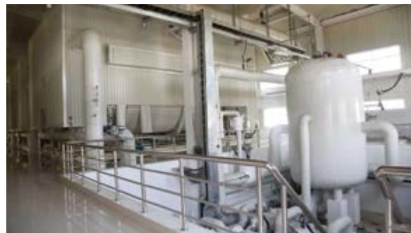
热泵房内部 Inside of heat pump house
