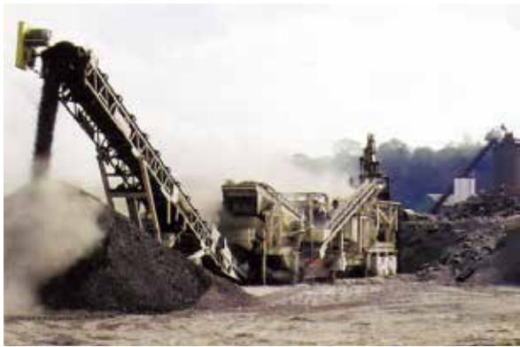
用于生产混凝土的石子生产线
