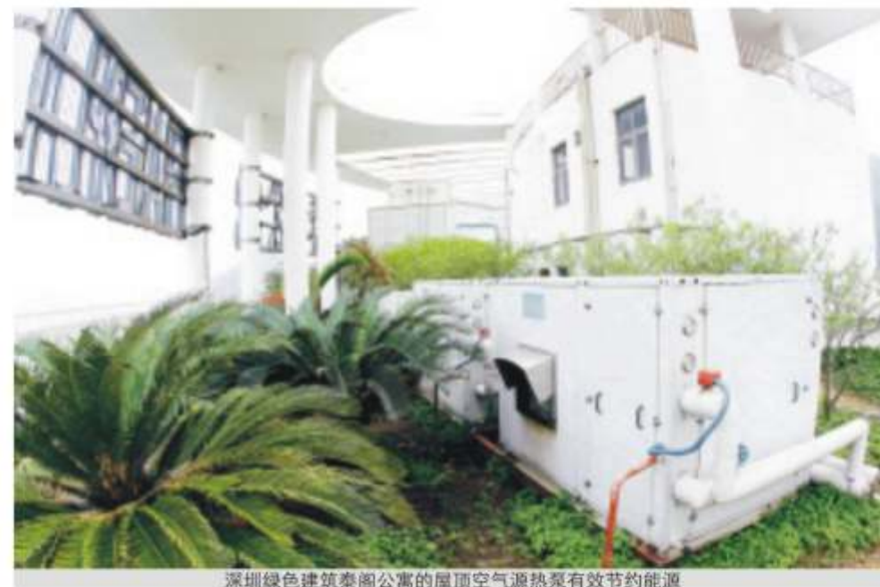
深圳绿色建筑泰阁公寓的屋顶空气源热泵有效节约能源
