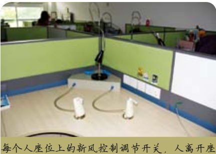
每个人座位上的新风控制调节开关，人离开座位可以关闭减少通风能耗
