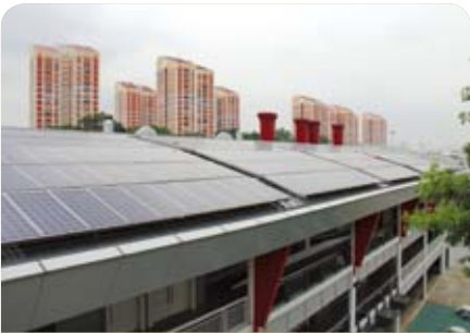
屋顶的太阳能电池板
