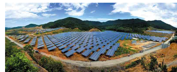
同景集团光伏发电项目全景图
